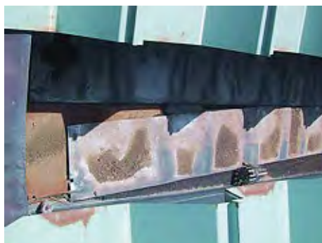
屋外に露出で敷設するとヒーターを劣化させる
