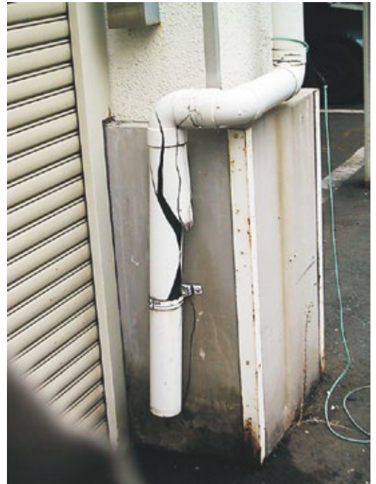
凍結で破損した雨樋（塩ビ製・縦管）
